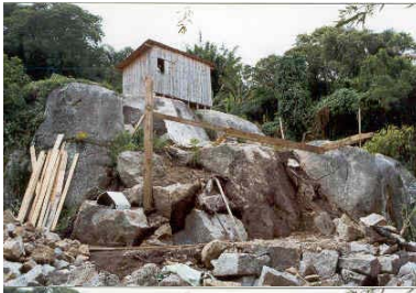
Foto do início das obras, primeiras escavações. Fonte: arquivo pessoal do arquiteto.
