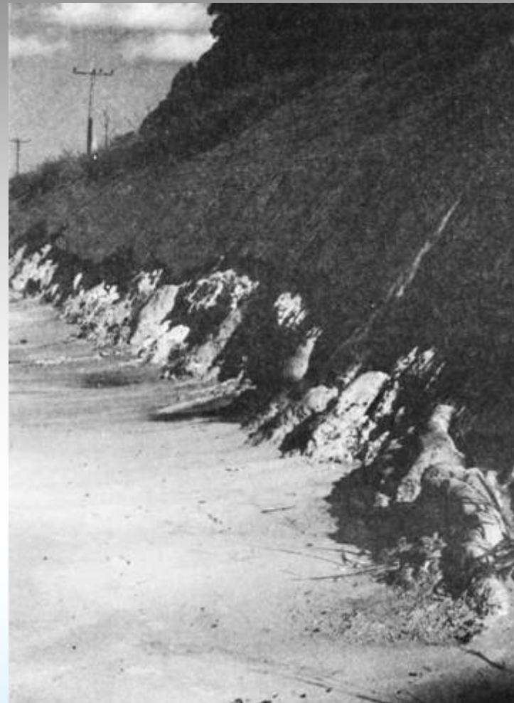
Erosão em talude de rodovia – Fonte IF
