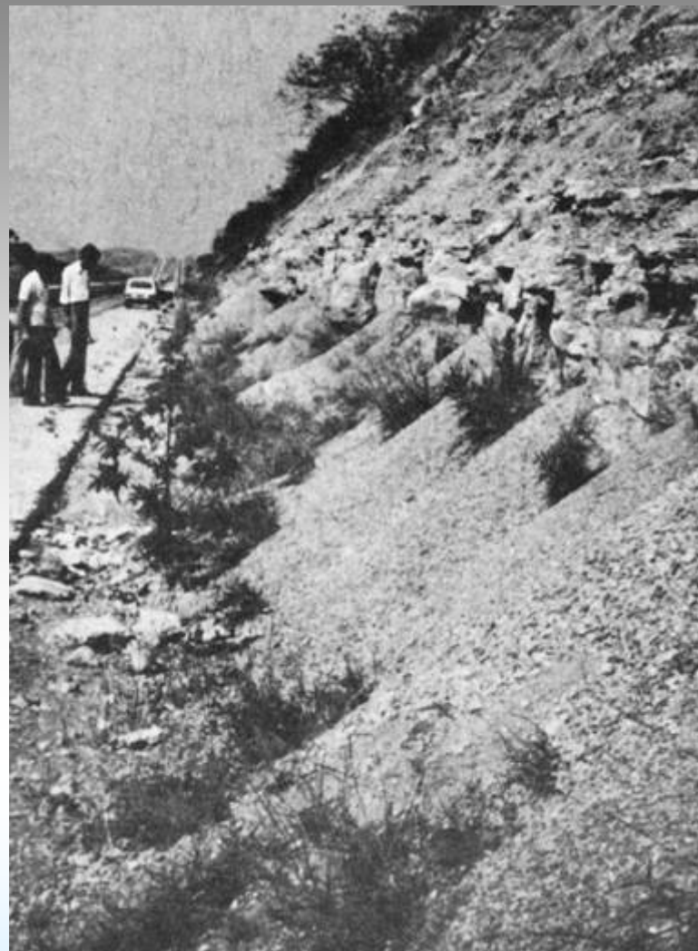
Desagregação Superficial – Fonte IPT
