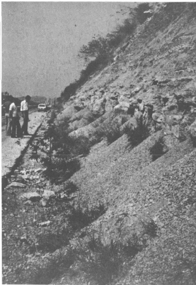
FIGURA IV.8 - Desagregação superficial em taludes
