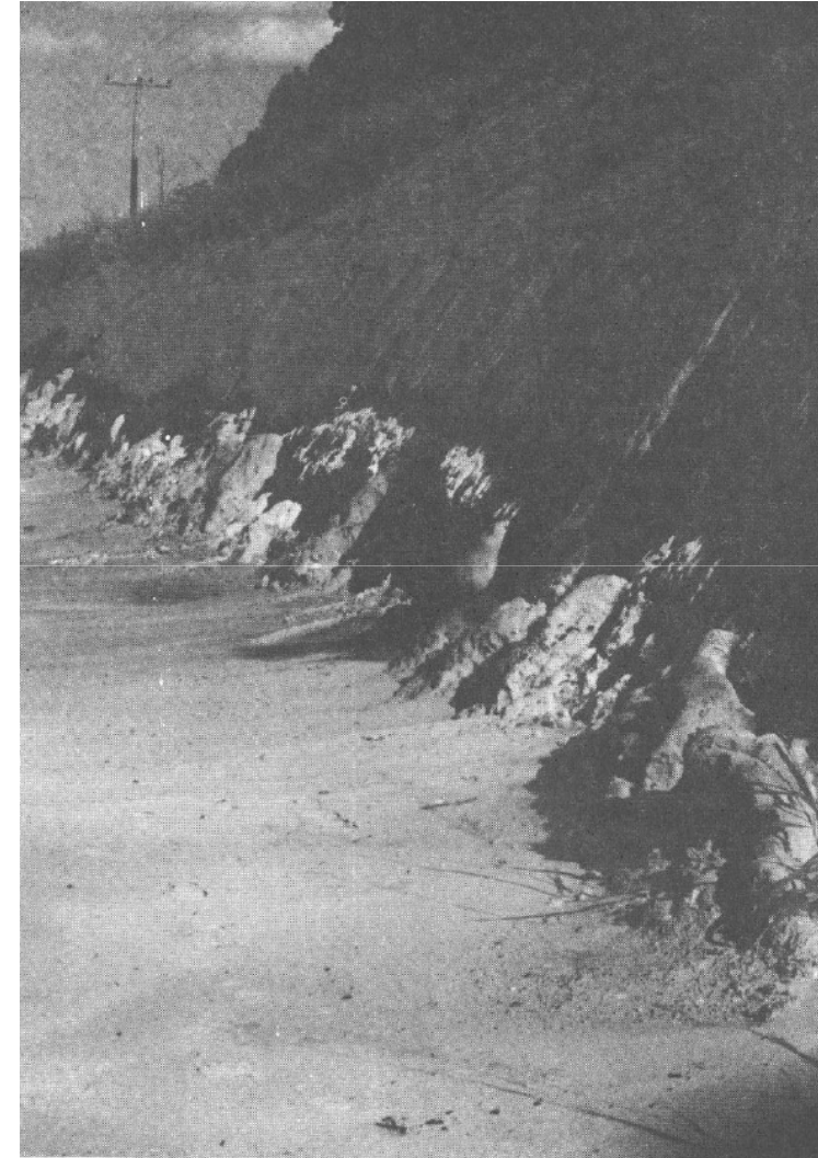
FIGURA IV.2 - Erosão em talude de rodovia
